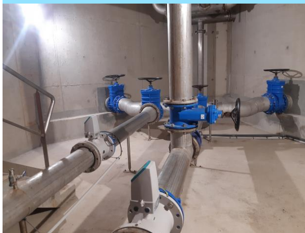
Equipements du réservoir
