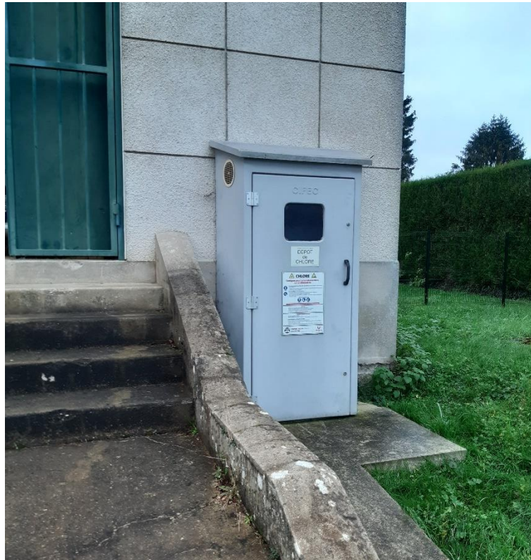
Figure 9 : Stockage du chlore gazeux
