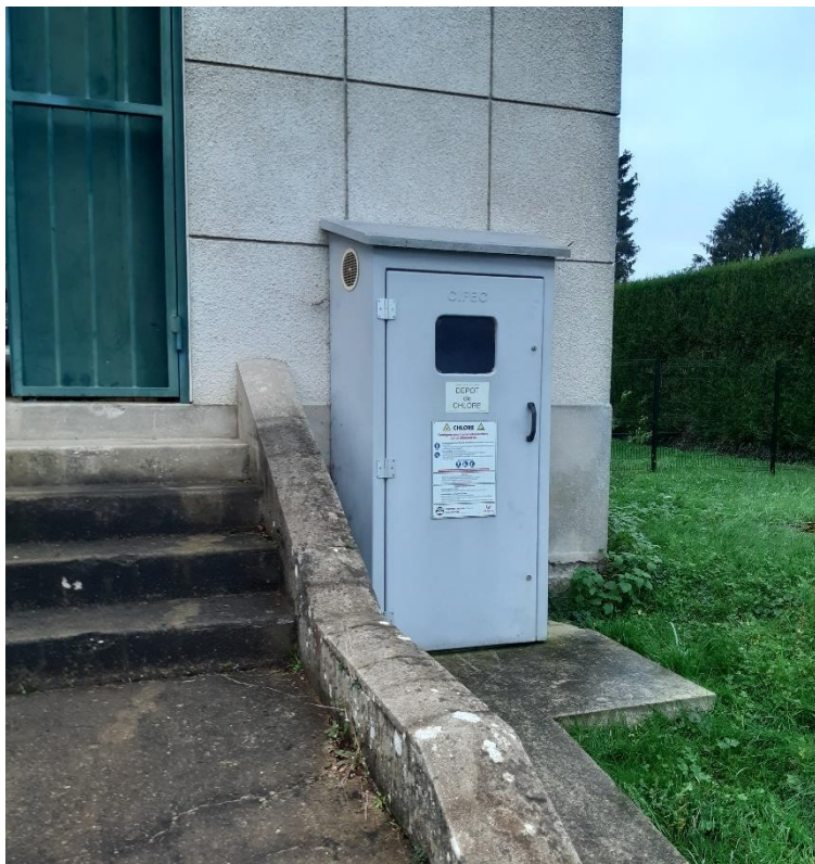
Figure 9 : Stockage du chlore gazeux
